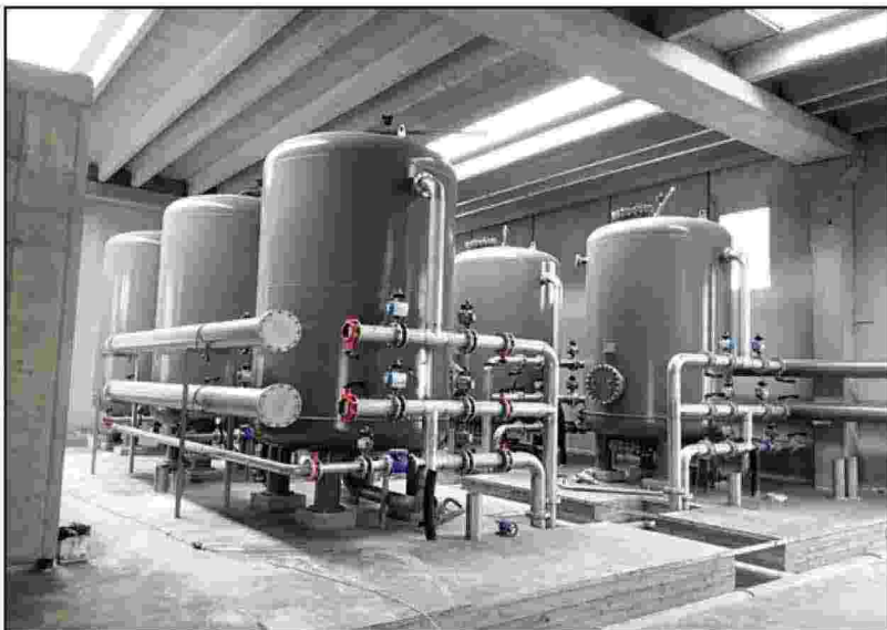
Centrale di potabilizzazione "Fontanino" (Villa Guardia) - altra infrastruttura strategica nell'ottica dello studio di connessioni intercomunali
